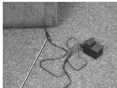
Conexión del transformador de energía
