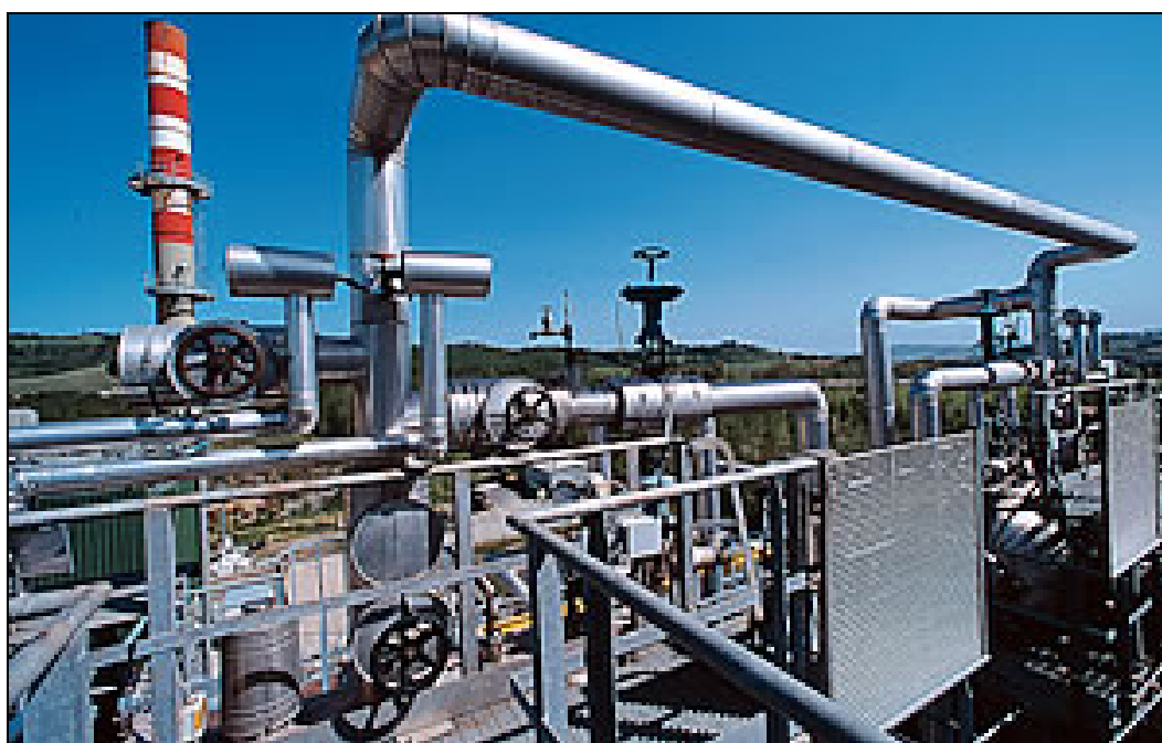
Impianto di termoutilizzazione SIENA AMBIENTE S.p.A.
