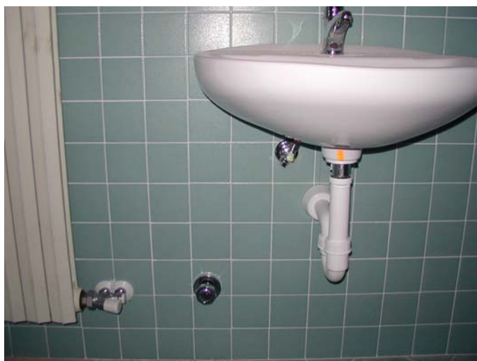
Rubinetto per chiusura alimentazione WC da vasca acque piovane.
