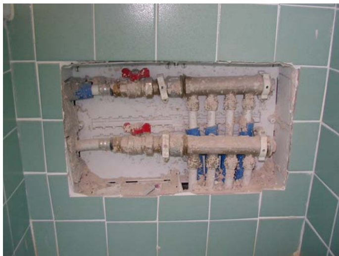
Cassetta collettori di distribuzione dell'acqua
