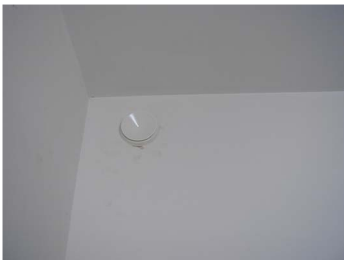
La bocchetta di aspirazione all'interno della camera da letto
