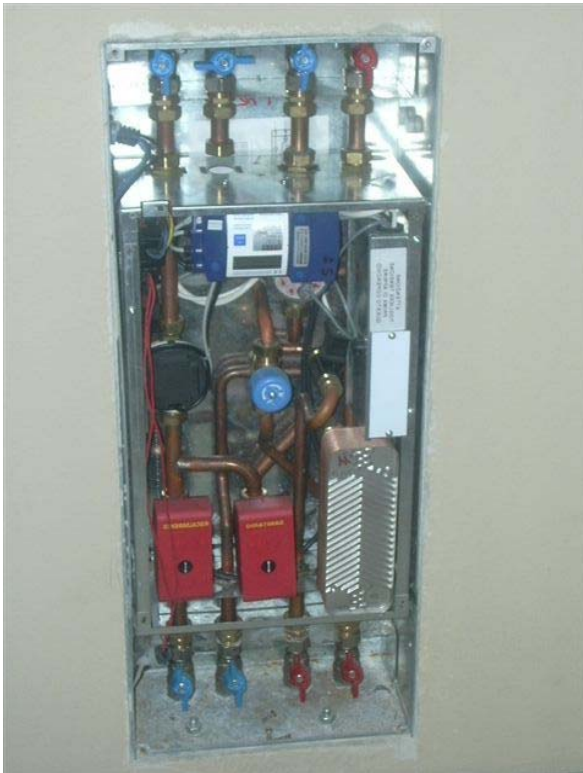
Il modulo termico d'alloggio
