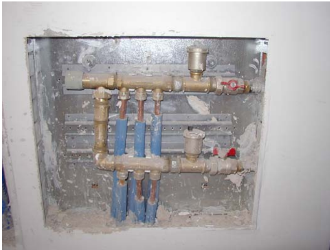
Cassetta del circuito dei radiatori
