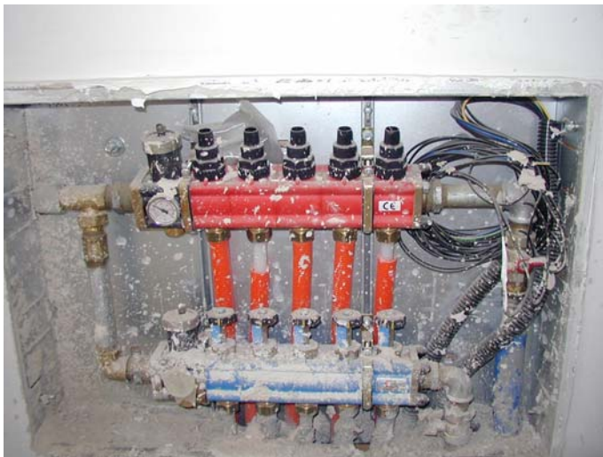
Cassetta del circuito dei pavimenti radianti
