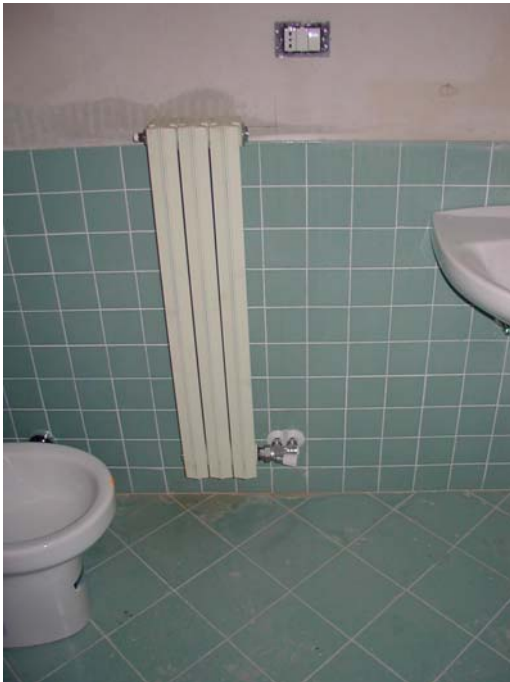
Il radiatore presente all'interno dei bagni
