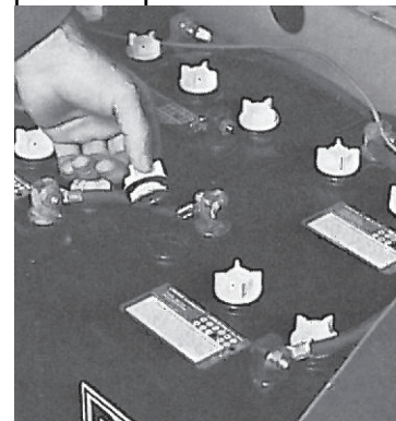
32-Controllare il fluido delle batterie
