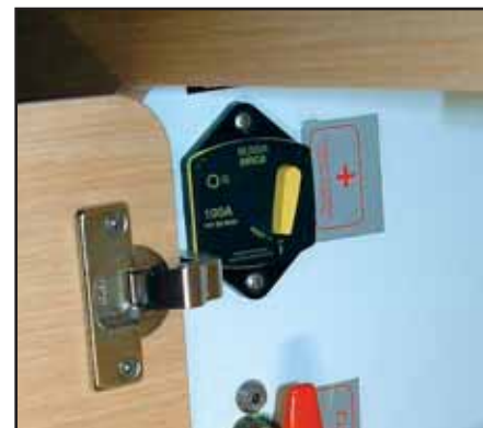
DISGIUNTORE DEL VERRICELLO SALPANCORA (CABINA POSTERIORE DI BABORDO)
