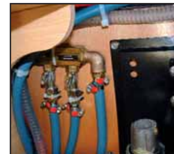
VALVOLE DI SELEZIONE SERBATOI
