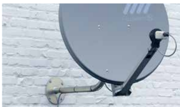
Fissaggio supporto parabola
