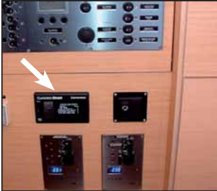
COMANDO DELL'AVVIAMENTO DEL GENERATORE
