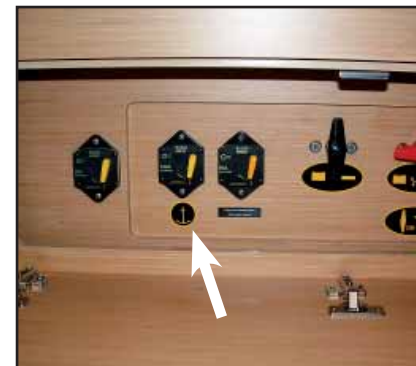
DISGIUNTORE DEL VERRICELLO
