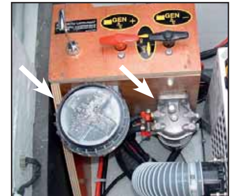
FILTRO AD ACQUA + FILTRO A GAS OLIO DEL GENERATORE
