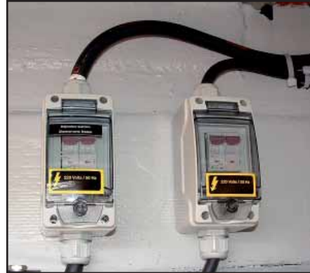
DISGIUNTORI DELLE PRESE DI BANCHINA
