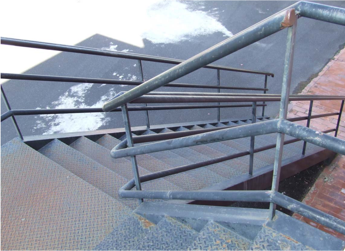
Scala di sicurezza nella sede staccata
