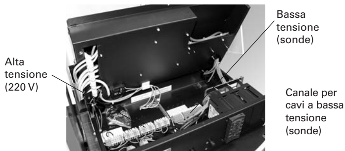
Fig. 54 - Quadro comando inferiore con morsettiere.
