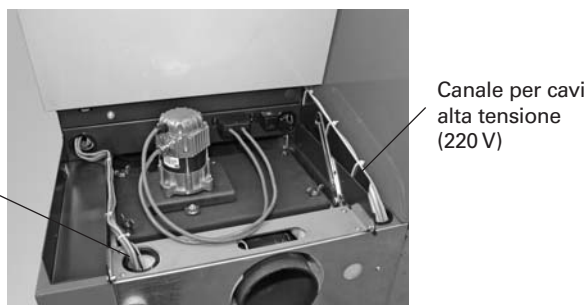
Fig. 55 - Canali per cavi - Vista da dietro.
