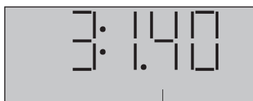
Parametro 3 Pendenza curva caratteristica circuiti miscelato 2
