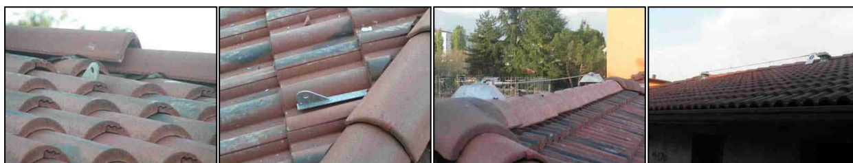
Esempi di sistemi di arresto caduta installati su coperture tradizionali
