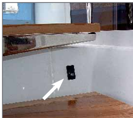
INTERRUTTORE SISTEMA DI CHIUSURA ACCESSO AL FLY (POZZETTO)
