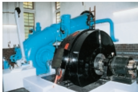
Nelle stazioni di pompaggio
