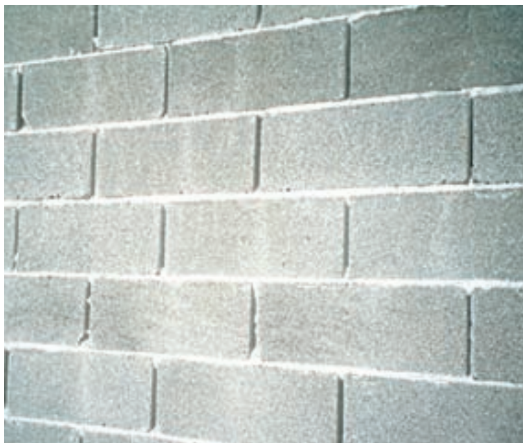
Il muro a blocchi in CLS ha le fughe verticali vuote
