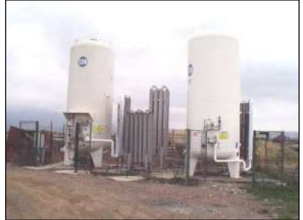
Serbatoi di ossigeno liquido
