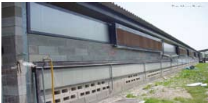
Figura 17. Impianto di raffrescamento ( cooling )
