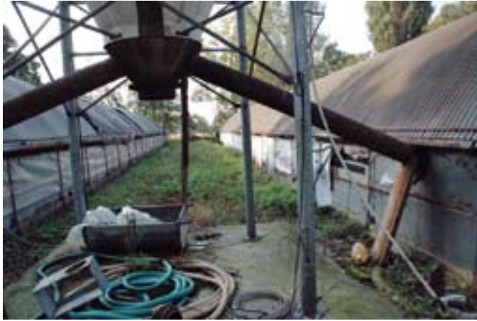
Figura 15. Negativo esempio di accumulo di materiale vario in corrispondenza del silos
