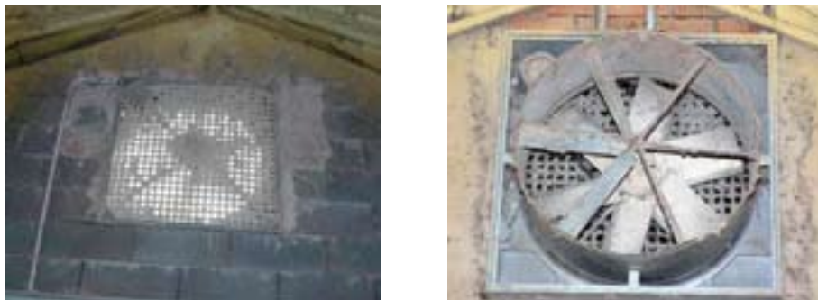
Figura 18. Polvere e pelo sulla parte interna (a sinistra) ed esterna (a destra) dell'impianto di ventilazione influiscono negativamente sulla qualità e quantità degli scambi gassosi
