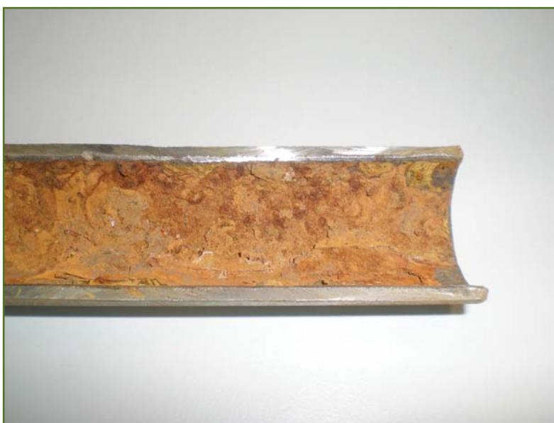
FIGURA 1 - Stato della superficie interna della tubazione prima dei trattamenti chimici
