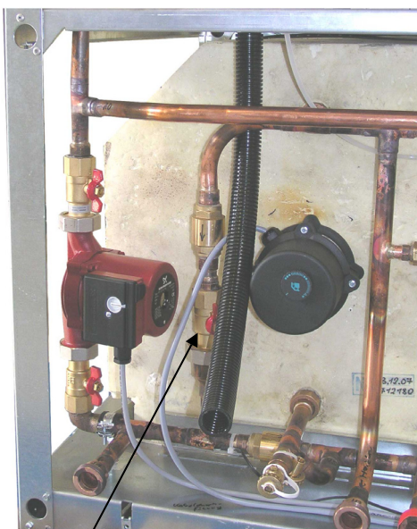
Robinet d'arrêt à boisseau sphérique situé au niveau de la distribution double sans pression différentielle
