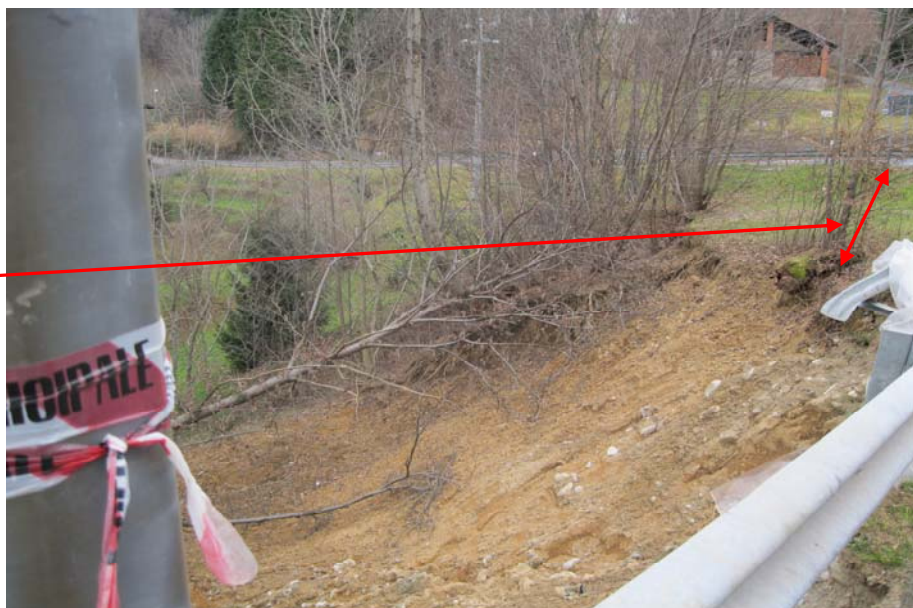
Particolare area franata su cui dovrà essere realizzato un piano di lavoro
