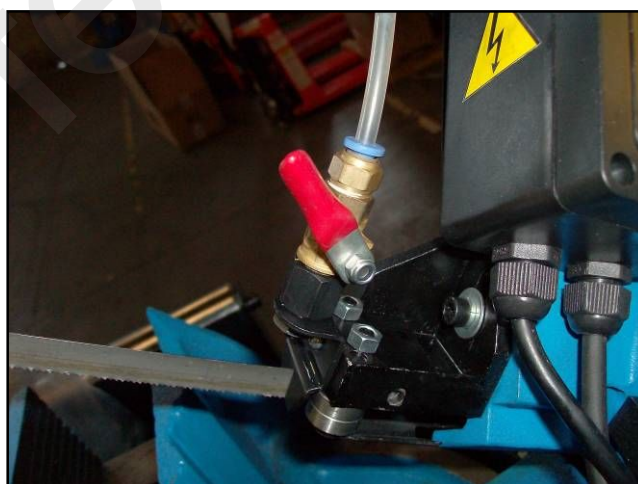
Figura 16 Ugello uscita liquido refrigerante.
