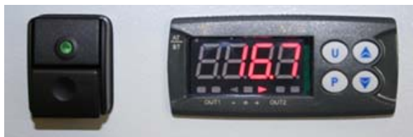
Dettaglio dei comandi del gruppo di refrigerazione
