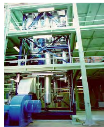
Figura 92. Impianto He-FUS3 (ENEA, Brasimone)
