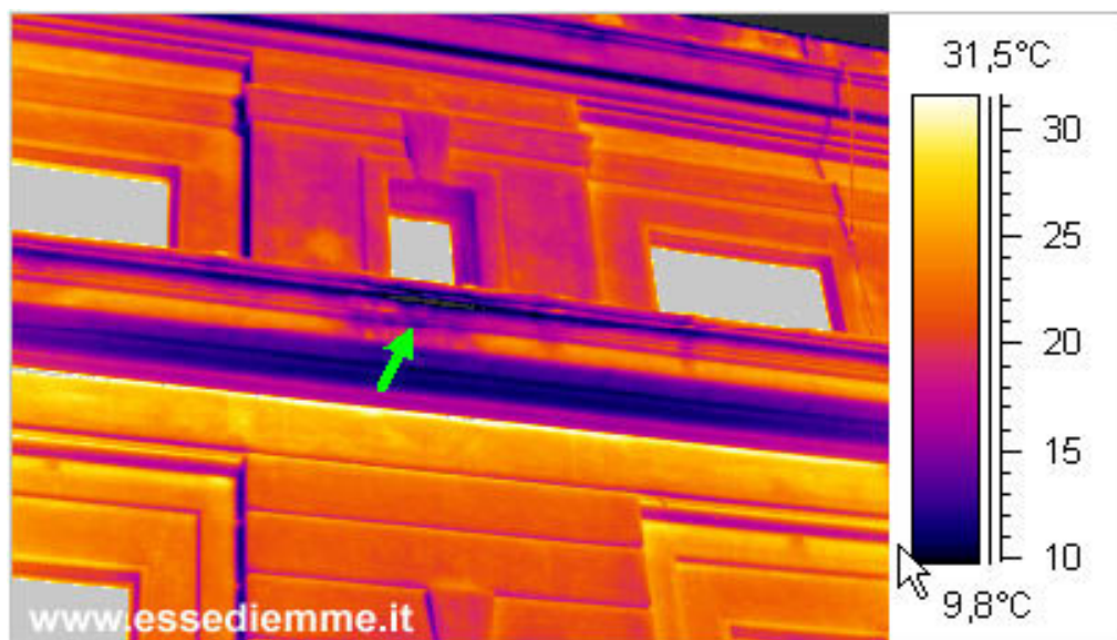
Figura 12: Verifica dello stato di cornicioni con individuazione delle zone interessate da infiltrazioni e ristagni di umidità con conseguente rischio di danneggiamento degli intonaci.
