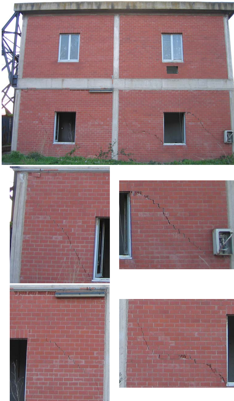
Fig. 6.19b: III ciclo di carico (punto B): Danneggiamento pareti lato Est.
