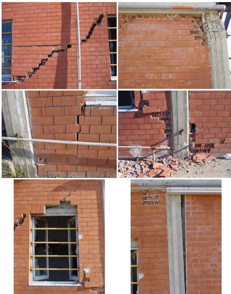
Fig. 6.24b: III ciclo di carico (punto F): Danneggiamento pareti lato Ovest (particolari).
