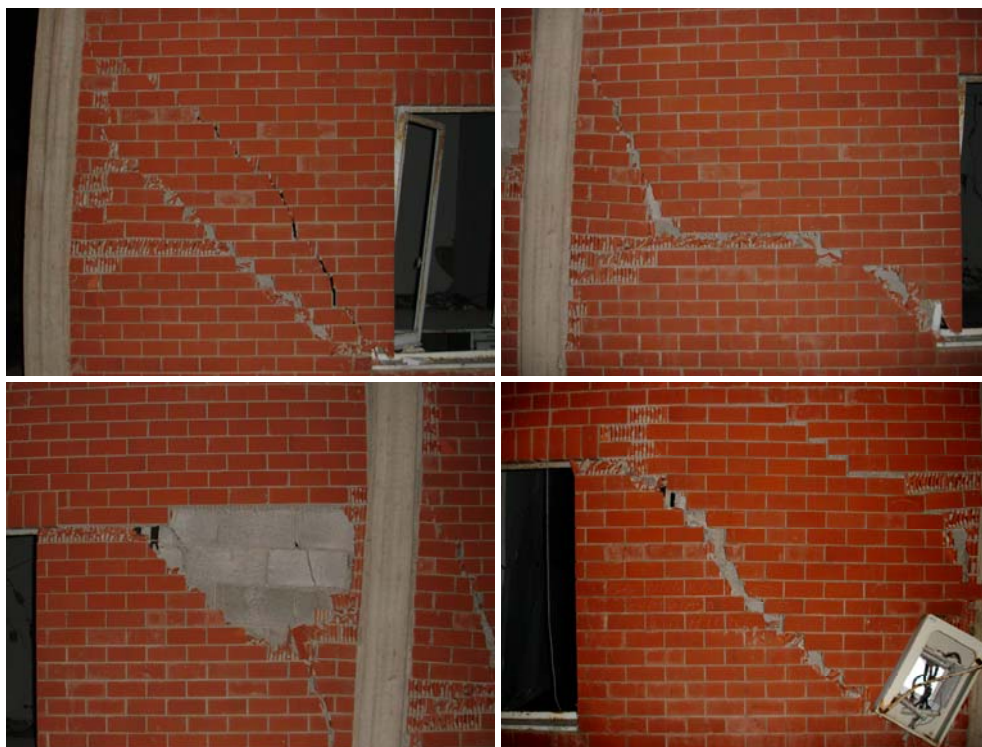
Fig. 6.23b: III ciclo di carico (punto E): Danneggiamento pareti lato Ovest.
