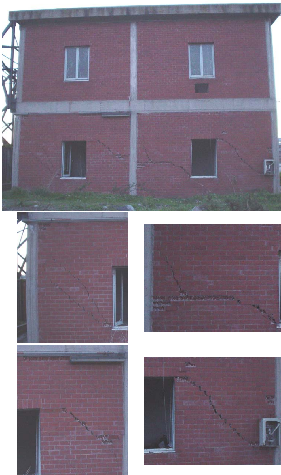
Fig. 6.21b: III ciclo di carico (punto C): Danneggiamento pareti lato Est.
