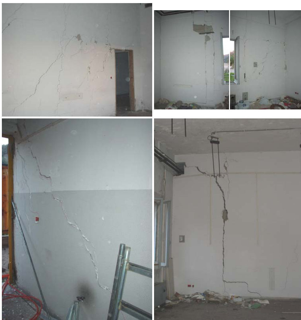
Fig. 6.20b: III ciclo di carico (punto B): Danneggiamento all'interno dell'edificio.
