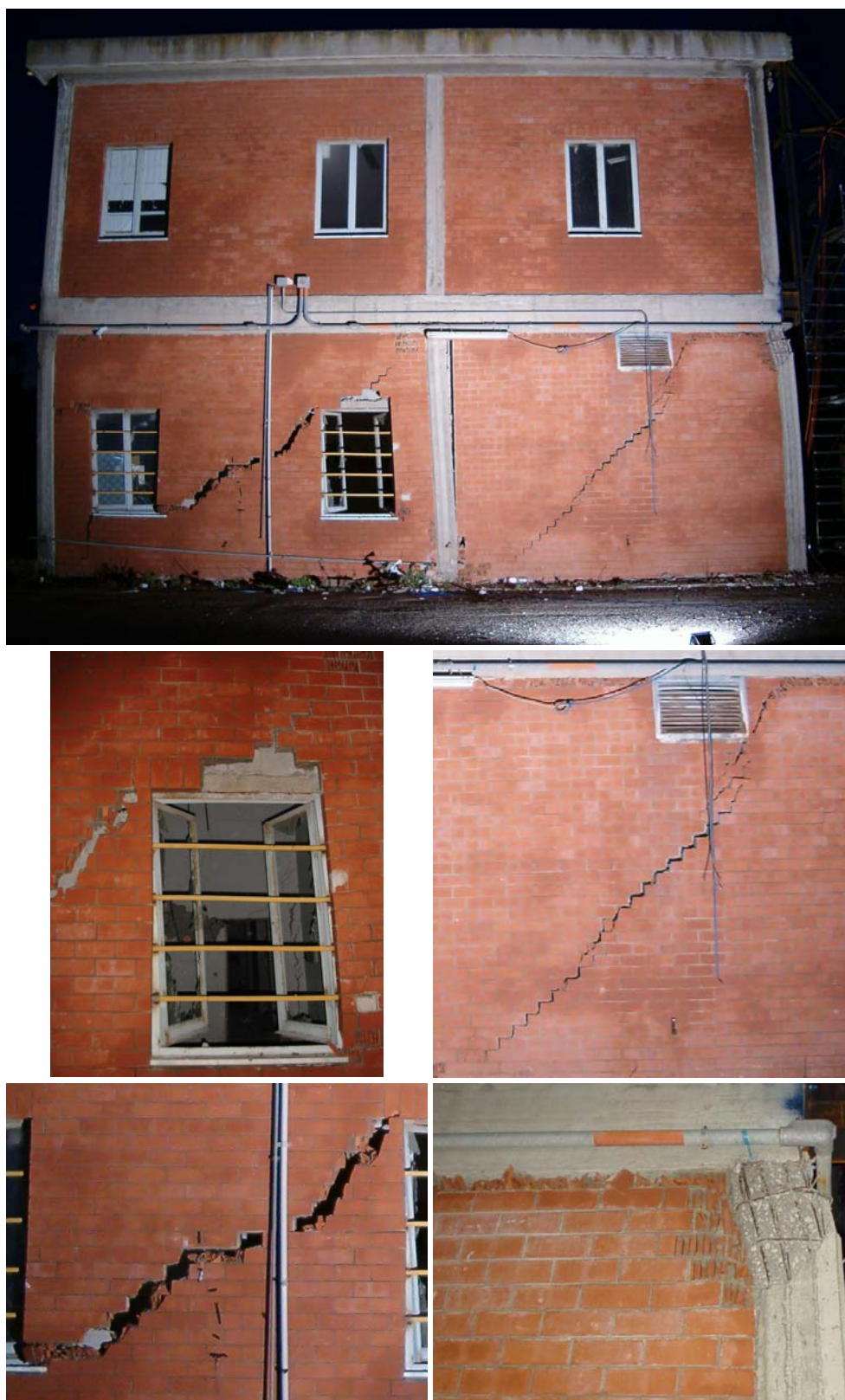
Fig. 6.23a: III ciclo di carico (punto E): Danneggiamento pareti lato Ovest.
