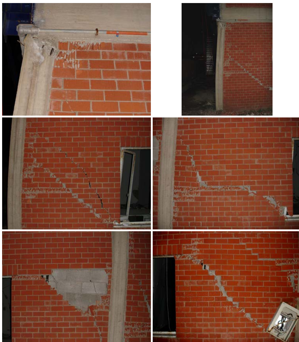
Fig. 6.22b: III ciclo di carico (punto D): Danneggiamento pareti lato Est.
