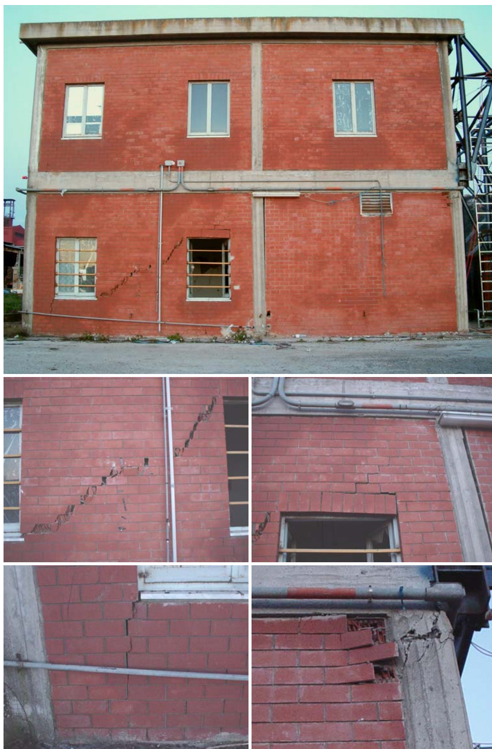
Fig. 6.21a: III ciclo di carico (punto C): Danneggiamento pareti lato Ovest.
