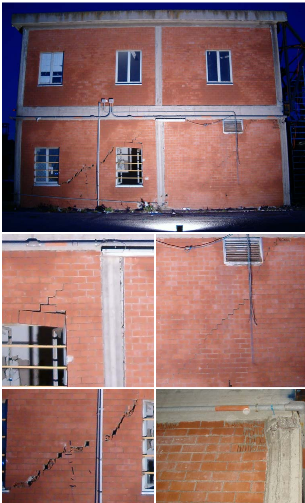
Fig. 6.22a: III ciclo di carico (punto D): Danneggiamento pareti lato Ovest.
