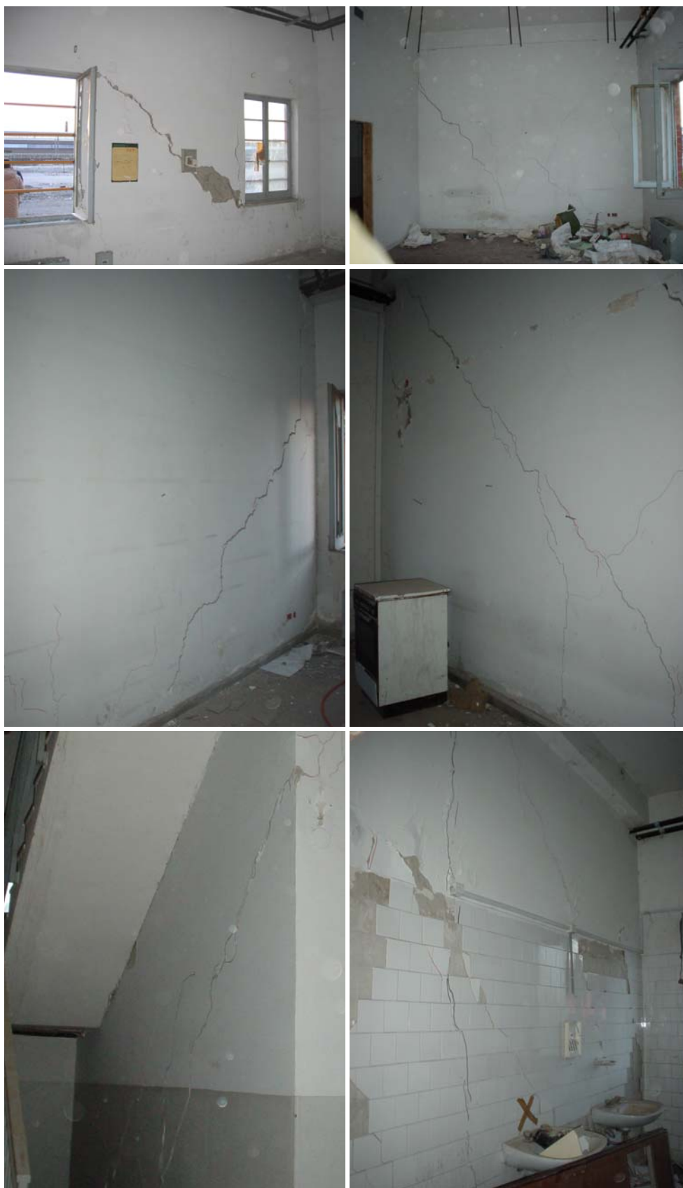
Fig. 6.20a: III ciclo di carico (punto B): Danneggiamento all'interno dell'edificio.
