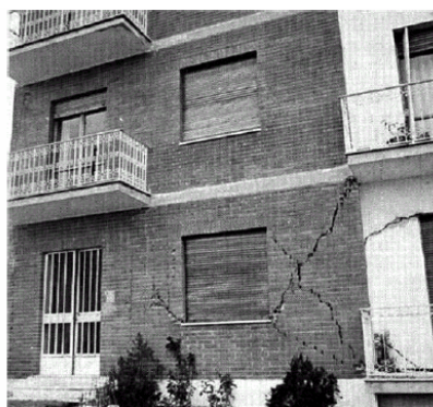
Fig.7.12: Daneggiamento delle tamponature con la struttura integra
