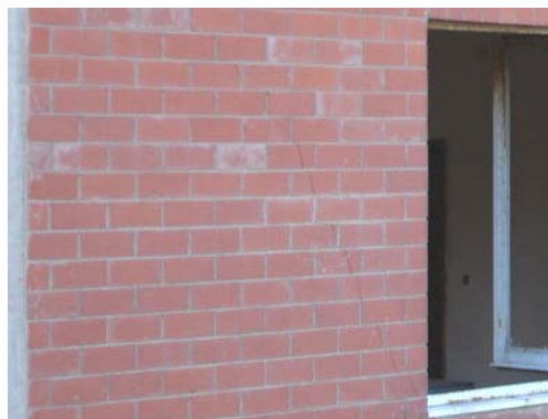
Fig. 6.18b: III ciclo di carico (punto A): Apertura lesioni sulla parete lato Est.
