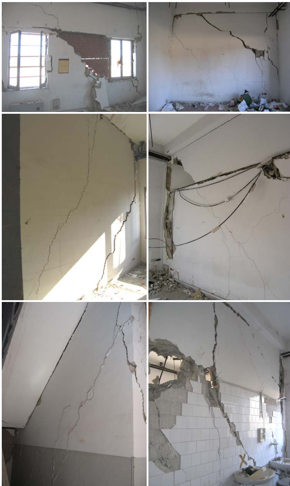
Fig. 6.25a: III ciclo di carico (punto F): Danneggiamento all'interno dell'edificio.
