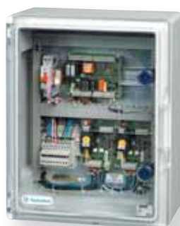
Quadro elettrico di regolazione
