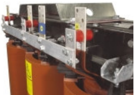
Collegamenti lato BT.
