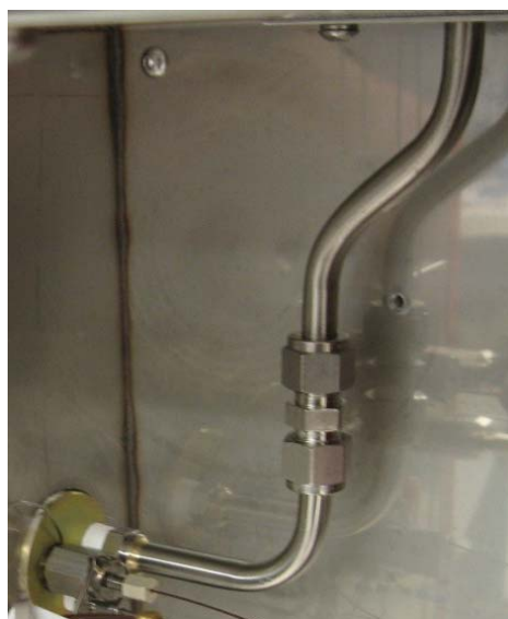
Riscaldatore installato (con canalina)
