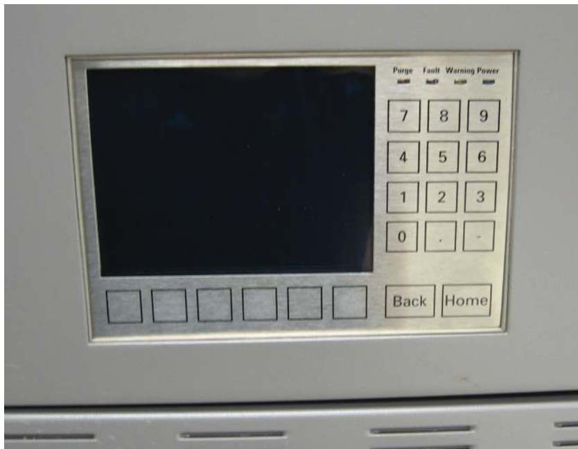
Figura 5-1 Pannello di manutenzione
