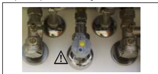
Figura: attacco gas: pericolo di asfissia e di esplosione per fuoriuscita di gas
