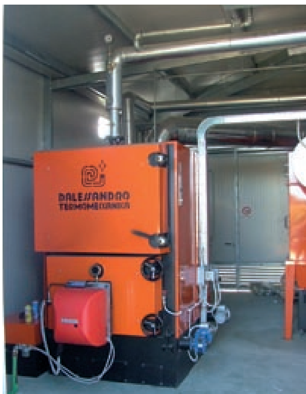
Caldaia a Biomasse
