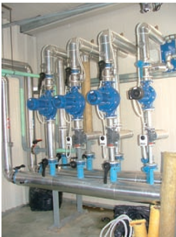
Collettori alimentazione circuiti aerotermi, termosifoni ad anello e vasi a camicia
