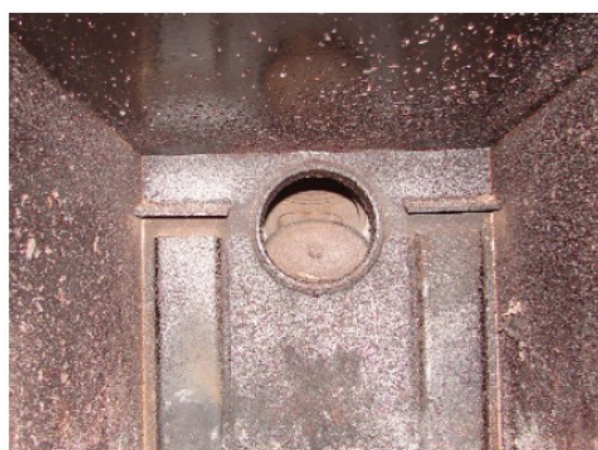
Camera di combustione dopo pochi giorni di funzionamento. La formazione del catrame è normale. Esso verrà nuovamente bruciato con la prossima fase di riscaldamento.
