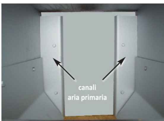
Camera di combustione di una caldaia nuova
