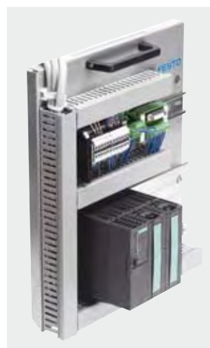
Pannello PLC con controllore programmabile Siemens mod. S7-300
