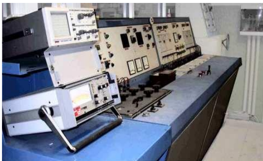
Sala prove trasformatore MT
