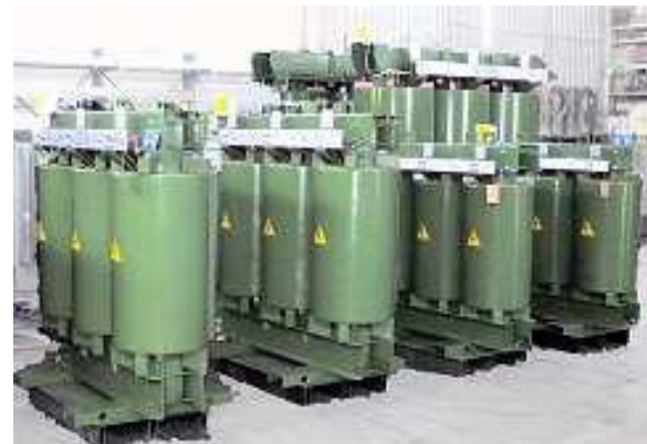
Trasformatori in resina pronti al collaudo
