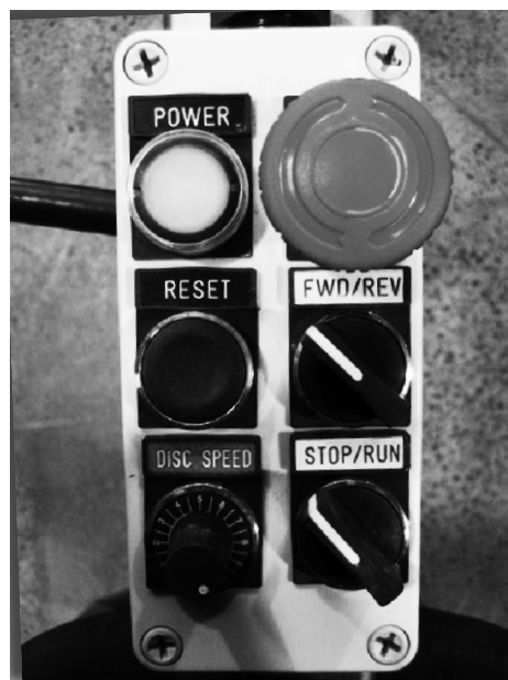
Quadro di comando
