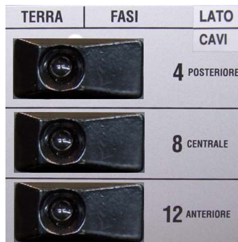
Fig. 6.3 - Dispositivo completo P/A tensione
