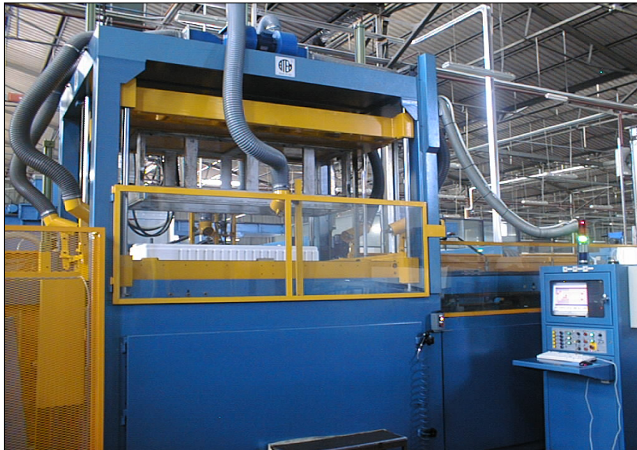
Foto 3 – impianto per la termoformatura delle vasche interno frigo in polistirene (sono visibili i condotti del sistema di aspirazione ed abbattimento di fumi e polveri).
