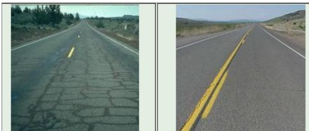
Figura 44: Higway 395 (USA) dopo 16 anni si servizio: a sinistra conglomerato bituminoso tradizionale, a destra conglomerato bituminoso con polverino di gomma
