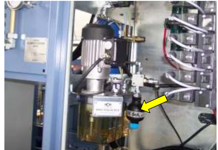
Verifica precarica accumulatore impianto precarico mandrino
