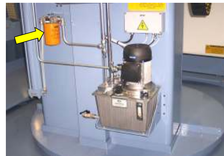
Sostituzione filtro impianto bilanciamento idraulico carrello multipallet
