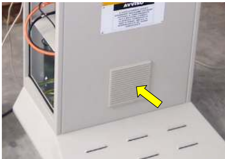
Pulizia filtro ventilatore supervisore tipo J-NODE 1 (cod. ric. SK 3322.700)
