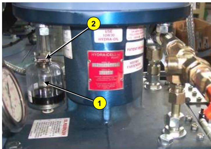
Verifica, ed eventuale rabbocco, olio pompa alta pressione refrigerante
