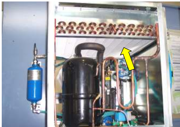
Pulizia condensatore gruppo frigo impianto raffreddamento motore mandrino
