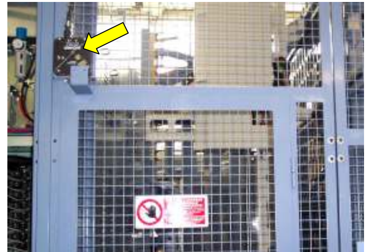
Verifica chiavistello sul cancello di accesso al manipolatore utensili
