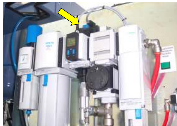
Blocco impianto pneumatico
