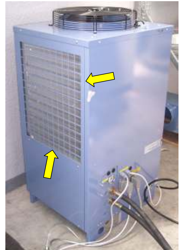
Pulizia condensatore gruppo frigo raffreddamento liquido vasca
