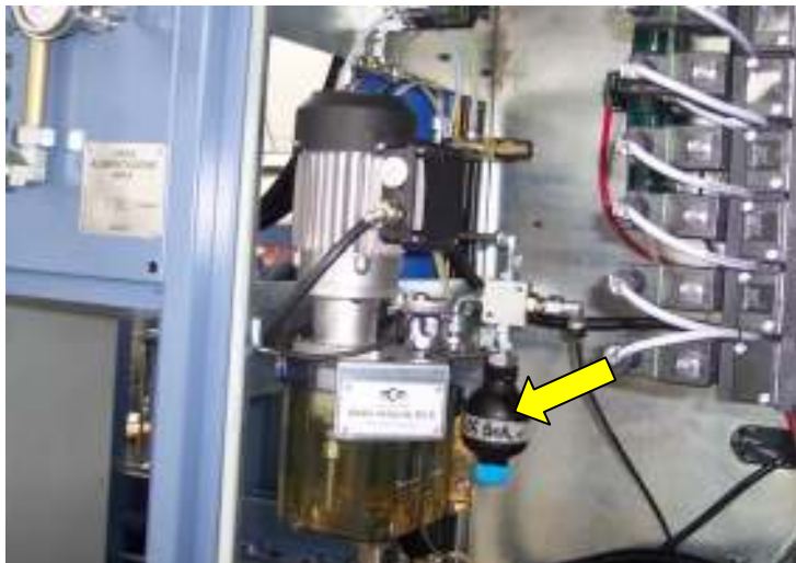
Controllo accumulatore impianto precarico mandrino
