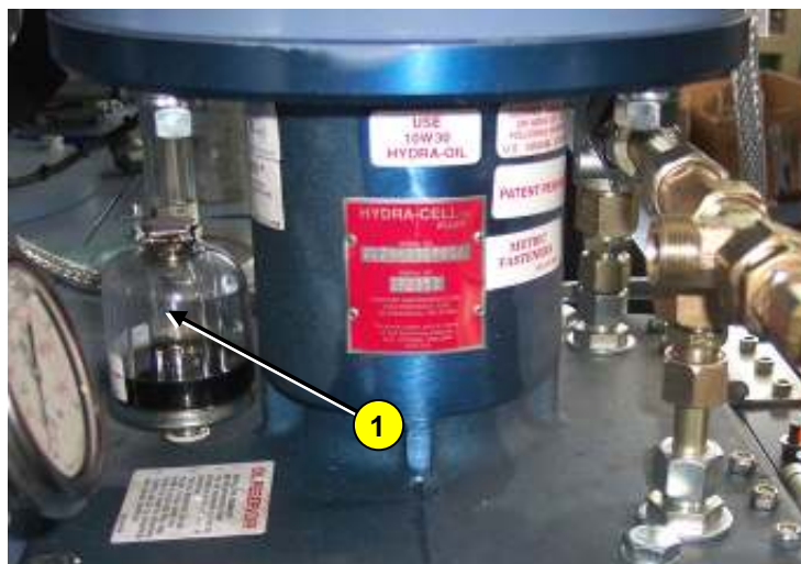
Sostituzione olio pompa alta pressione refrigerante
