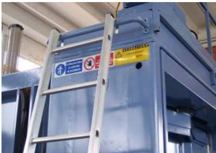
Scala di accesso alla parte superiore della Macchina
