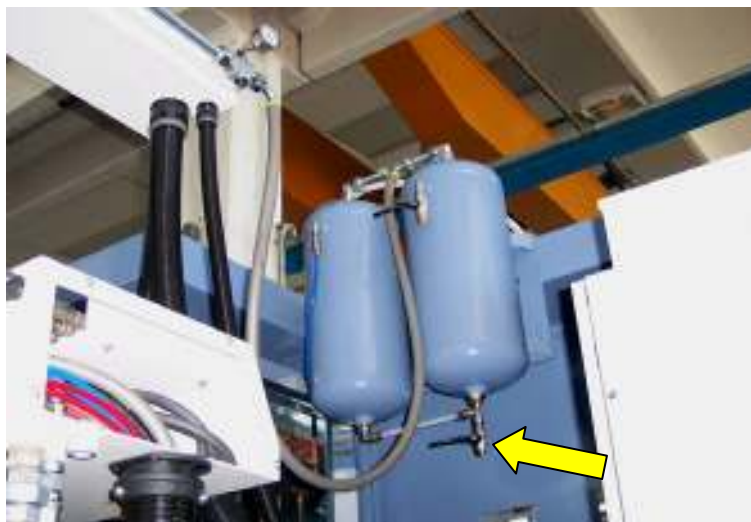
Scarico condensa accumulatori aria
