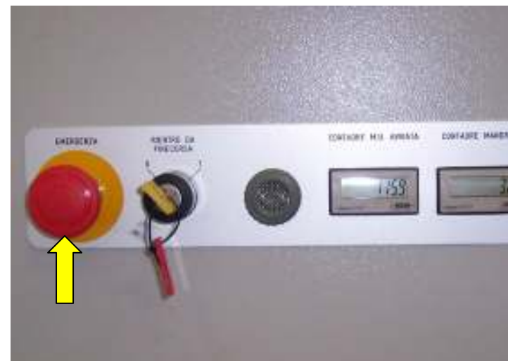
Pulsante d'EMERGENZA su armadio elettrico.
