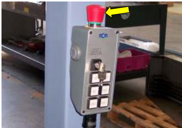
Pulsante d'EMERGENZA su pulsantiera rifasamento manipolatore utensili
