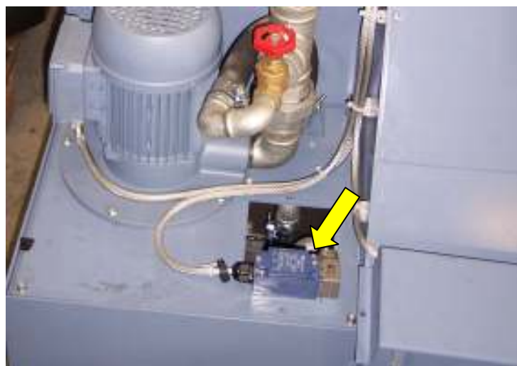
Controllo micro su vasca refrigerante
