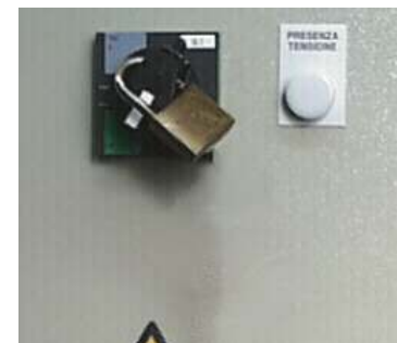
Interruttore generale impianto elettrico
