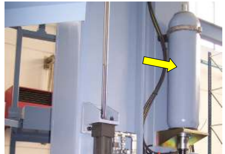
Controllo accumulatore impianto bilanciamento idraulico carrello multipallet
