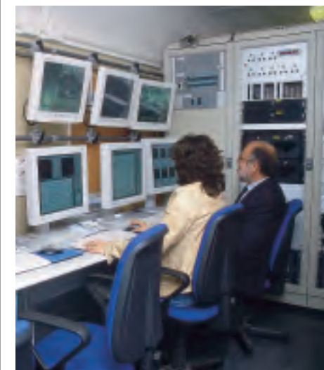
Un'immagine della sala controllo di Archimede.
