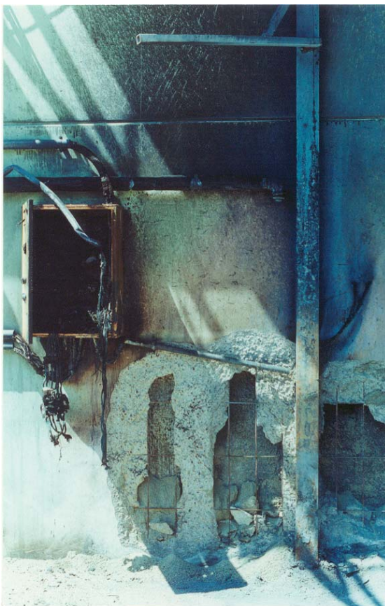
Fig. 23 Danni strutturali e quadro elettrico bruciato
