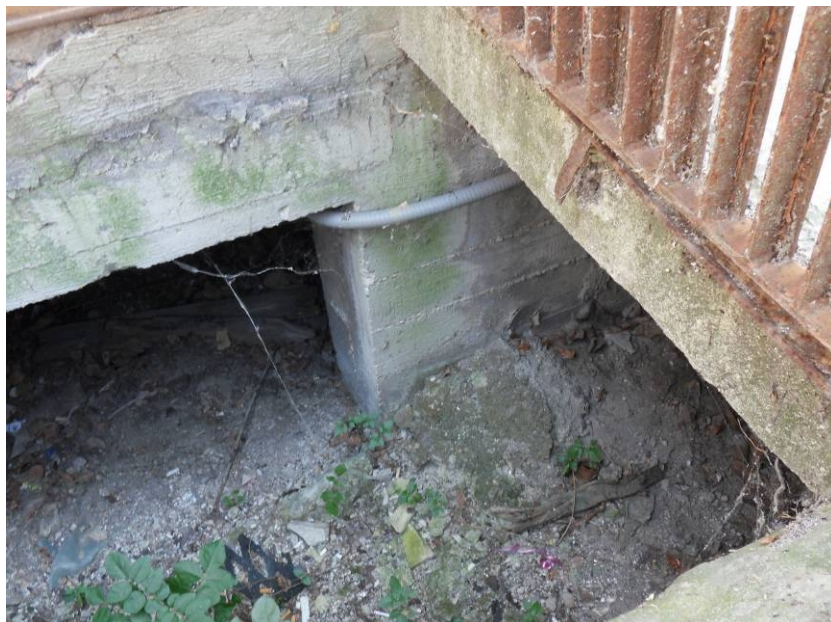
Figura 7 - Ingresso nuova linea a.c. d'impianto nel cavedio sotto solaio
