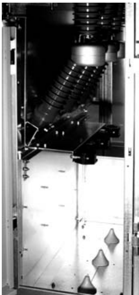
Vista del circuito di potenza View of power circuit
