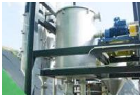
Foto 4 Filtro e Ventilatore di processo
