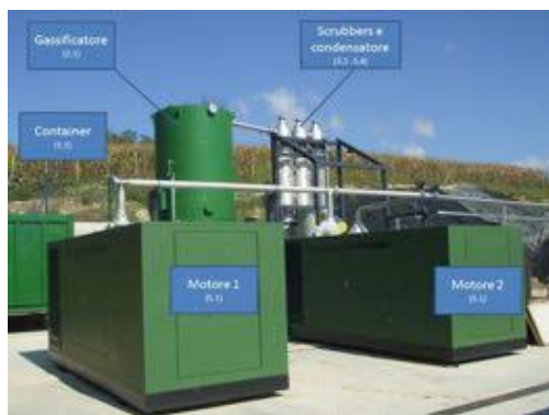
Foto 2 Impianto GenGas 200 NORMAL
