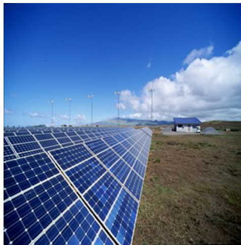
Fig. 2.9: Esempio di centrale solare.
