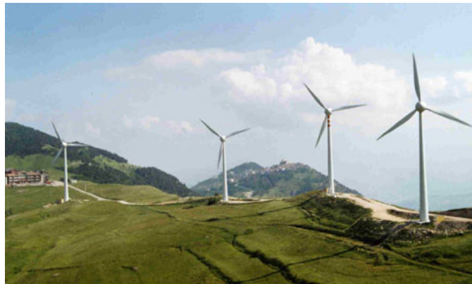
Fig. 2.7: Esempio di sito ospitante una centrale eolica.
