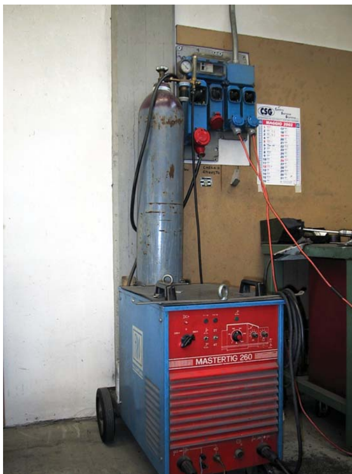
Figura 1 – Generatore e bombola di gas inerte
