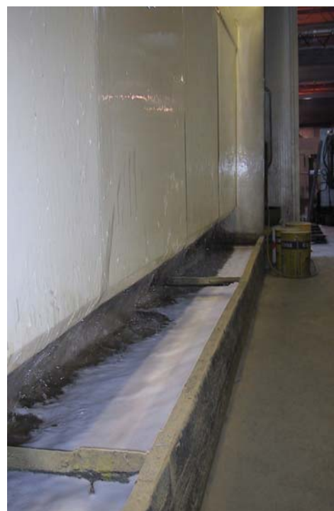
Figura 4 - Vasca di raccolta in cabina di verniciatura
