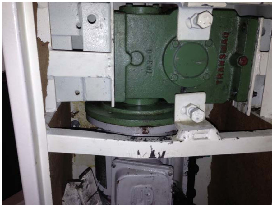
Figura 30: Redutor de velocidade acoplado ao motor. Fonte: Autoria própria.
