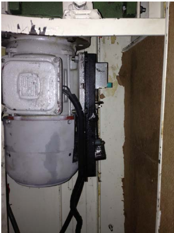
Figura 23: Motor da plataforma elevatória.
