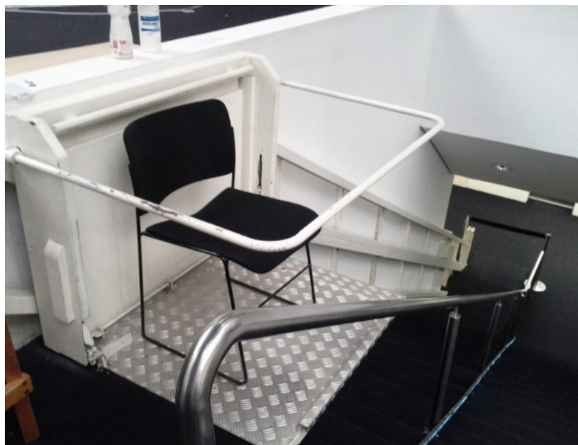
Figura 27: Vista total da Plataforma elevatória no Museu Oscar Niemeyer. Fonte: Autoria própria.
