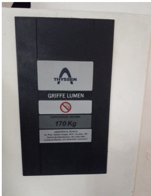
Figura 25: Painel de acionamento referente à plataforma elevatória. Fonte: Autoria própria.
