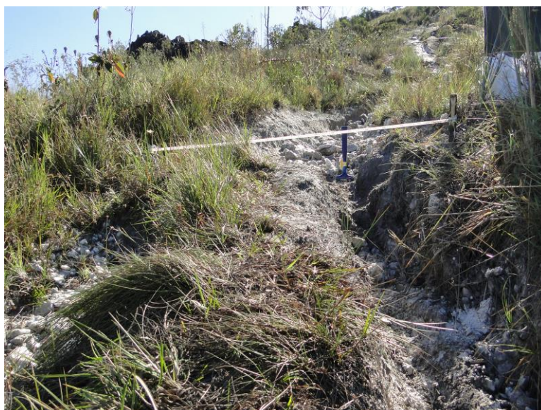
Figura 6: Trilha erodida pelo escoamento superficial concentrado. Foto: A.C. Campos
