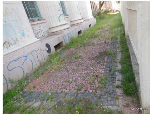
Áreas com acúmulo de areia e vegetação.
