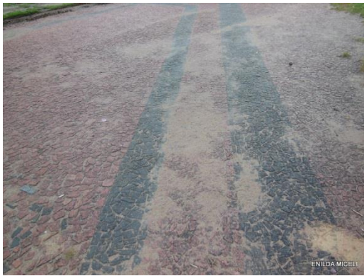
Áreas com acúmulo de areia.
