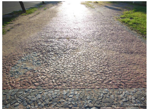
Observam-se zonas de irregularidade por má execução da pavimentação.
