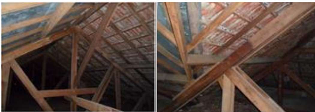
Fotos do telhado – situação atual, com um dos lados com subtelhado metálico.
