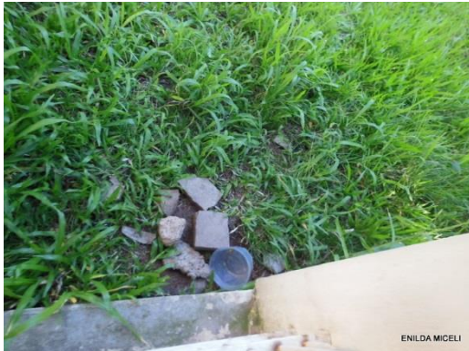
Pedras soltas pelo terreno
