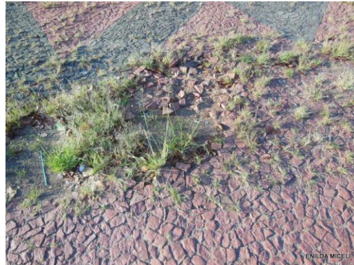
Lacunas na área externa ao gradil de entrada
