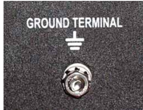
Figura 7 - Conexión a tierra del generador
