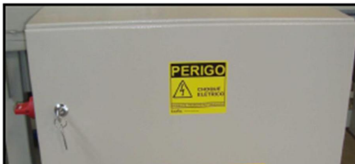
Figura 16 – Quadro de energia.
