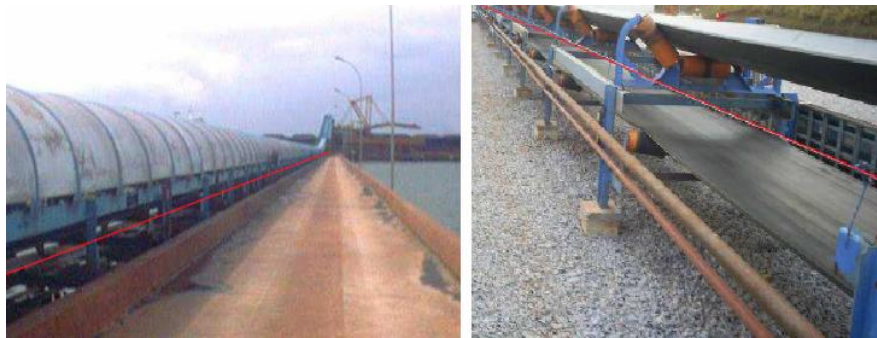
Figura 74 – Esteiras transportadoras, dispositivos de emergência.
