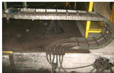
Figura 69 – Travessas para fixação de mangueiras pressurizadas.
