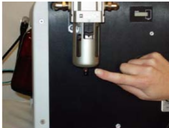
Figura 13: Drenagem do Filtro de Ar Externo
